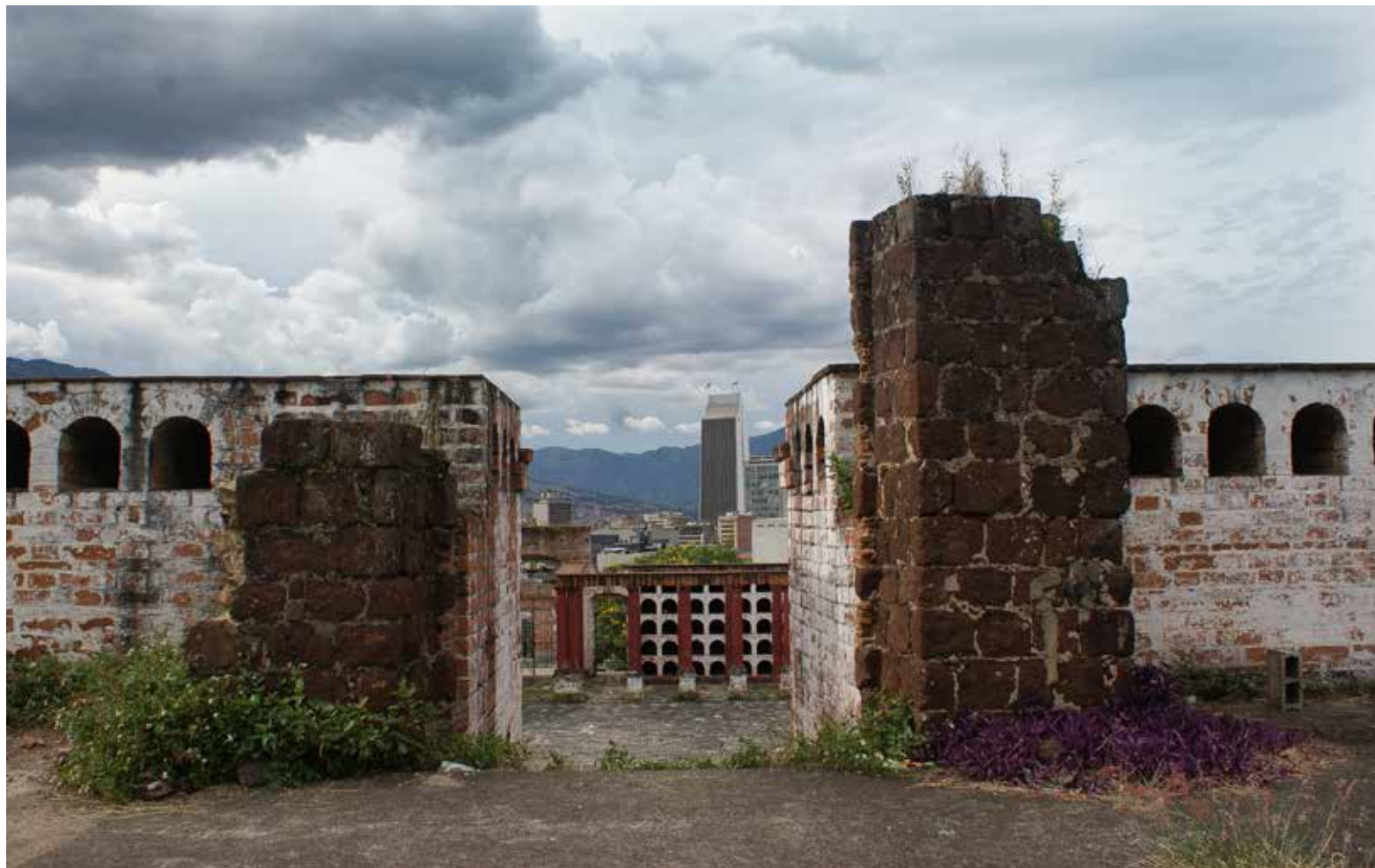
Esta celebración puede ser también una oportunidad de volver la mirada al cementerio San Lorenzo, que muestra deterioro. Está ubicado en el cerro de La Asomadera, llamado así porque era el mirador más cercano hacia el centro (toda la ciudad en ese entonces).
